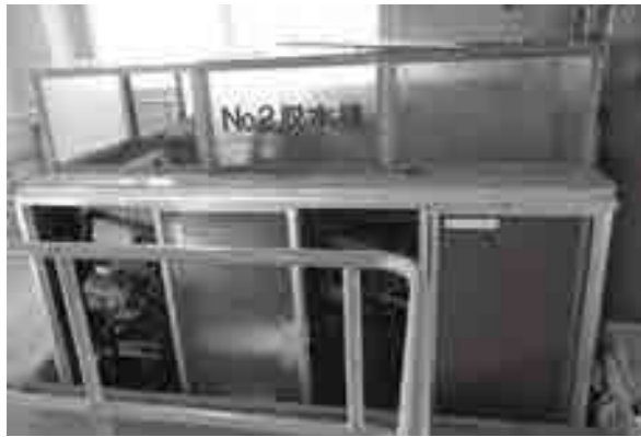
中央浄化センター脱水機
