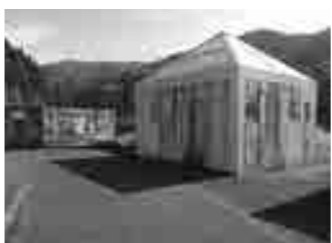
経年劣化したトイレの外壁
