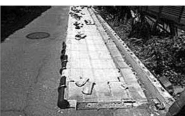
熊本地震によるブロック塀の倒壊事例
