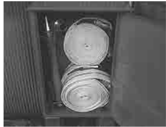
消火栓ホース格納箱
