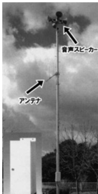
松岡地区に設置する屋外拡声局装置
